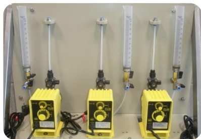
Skid 03 bombas dosadoras com provetas , estrutura em aço carbono com pintura epoxi , revestido em pp , fixação em parede.
