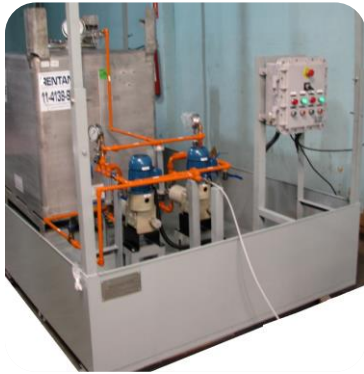
Sistema a prova de explosão para injeção de corantes em diesel.
