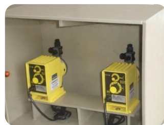
Skid 02 bombas dosadoras, estrutura em pp, fixação parede .
