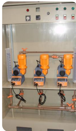
Skid bombas dosadoras com provetas , estrutura em pp , painel eletrico.
